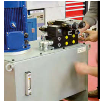
DISEÑO Y FABRICACION DE PROYECTOS HIDRÁULICOS DESIGN & MANUFACTURE OF MINI POWERPACK
